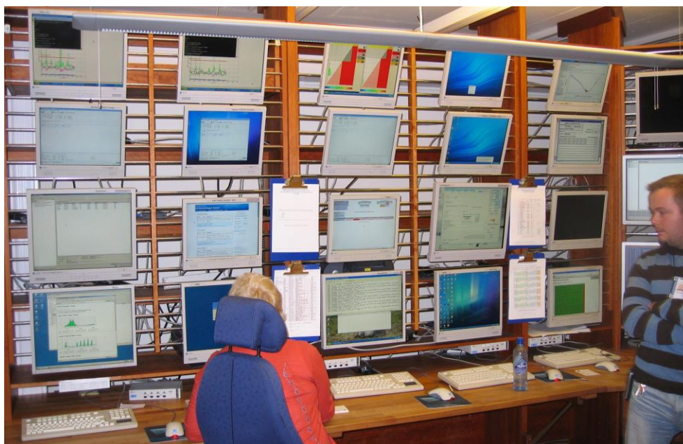
Figur 7: Tor-Ole Dahlø förevisar driftledningscentralen för SATREF vid Statens Kartverk i Hønefoss (foto: Dan Norin).
